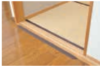
室内での設置
